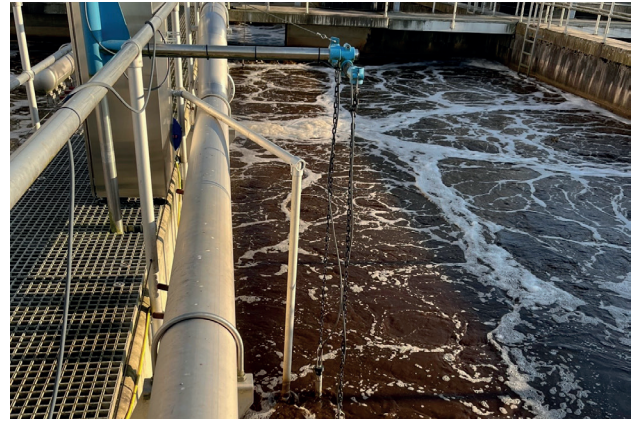
Abb. 3. Standort des 2026 Ammonium Prozess Analyzers inkl. Probenzufuhr und Sauerstoffmessstelle.
